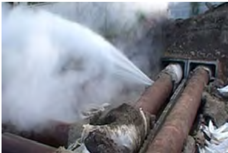
Рис. 6.1. Разрыв трубопровода высокого давления
